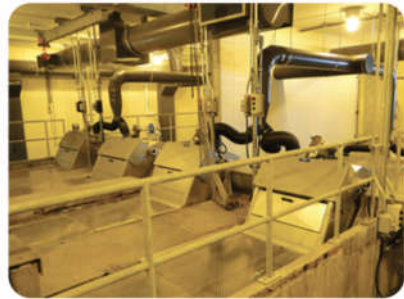
Mascouche-Lachenaie WWTP, QC (2010)
