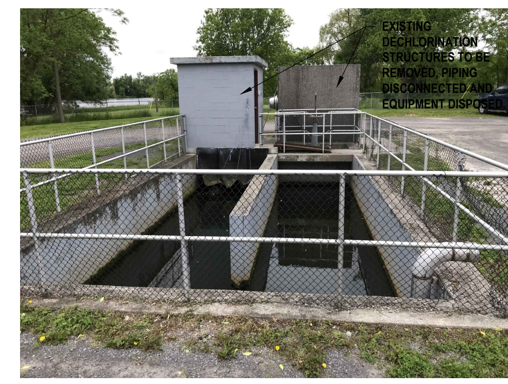
PHOTO #2 - CCT2 CHAMBER SCALE: N.T.S.
